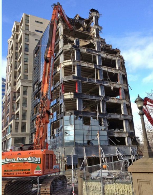
Bildo 2: La tertremoj detruis multajn konstruaĵojn sed aliaj ne falis. Tamen, ili estas en danĝera stato kaj tro kostas por ripari ilin. Oni nun devas malkonstrui multajn konstruaĵojn.
